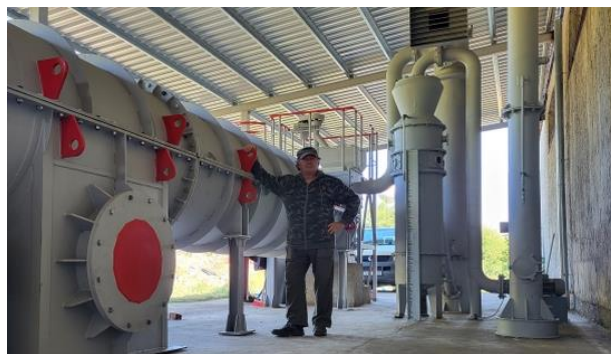
Zdjęcie 1: Instalacja 3R
