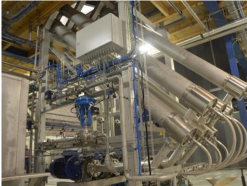
Figure 5: Ammoniumsulfat des VP-Hobe Gülle-Verwertungs-Systems (ID 1529)
