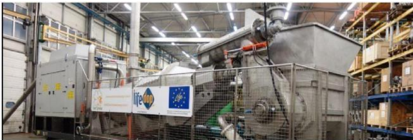
Abbildung 1.: Pilotanlage für mobile Güllekavitoren.
