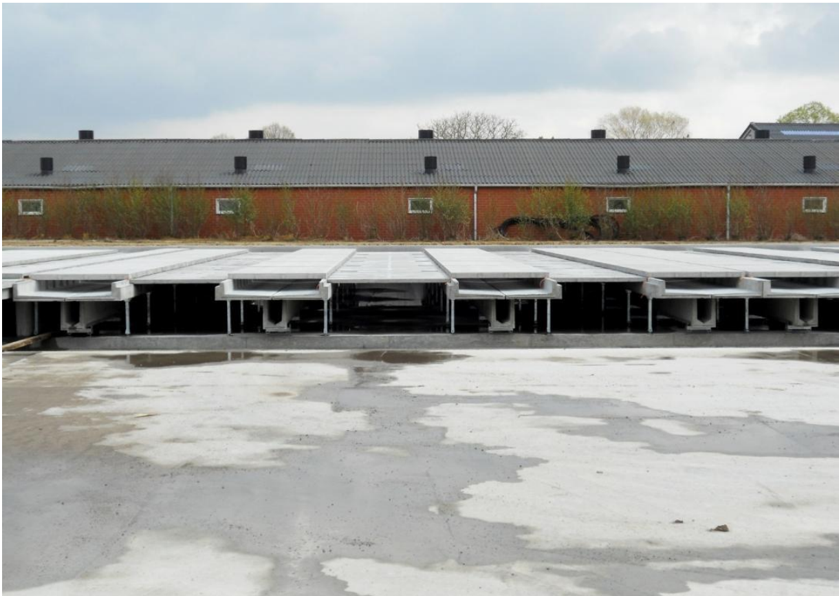
Figura 1. Planta para la recuperación de nitrógeno a partir de la fracción líquida de los purines mediante el sistema de construcción adaptada "VeDoWS".
