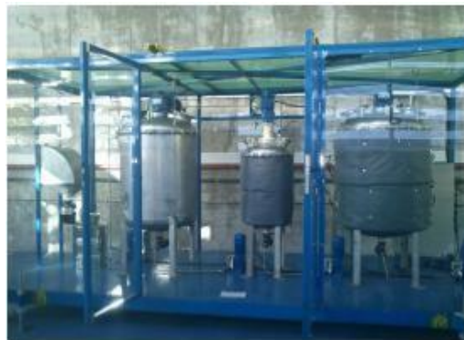
Figure 1. Installation de digestion anaérobie à deux phases VALUVOIL
