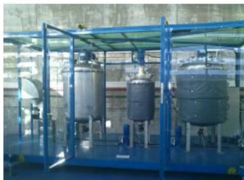
Figura 1. Planta de digestión anaerobia en dos fases VALUVOIL
